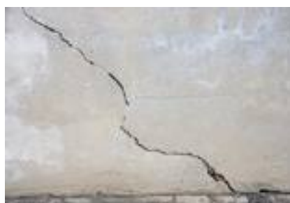
Verputzte Wand mit Rissen
